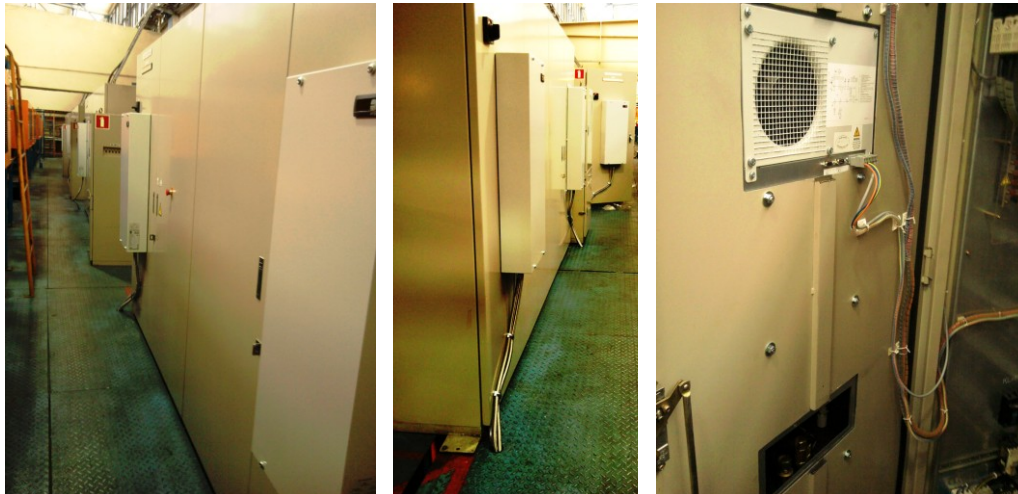
Ciąg szaf po modernizacji - wyposażone w wymienniki ciepła
