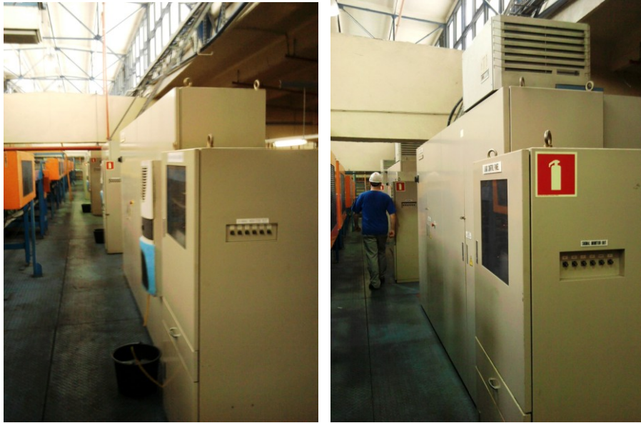
Szafy sterownicze przed modernizacją
