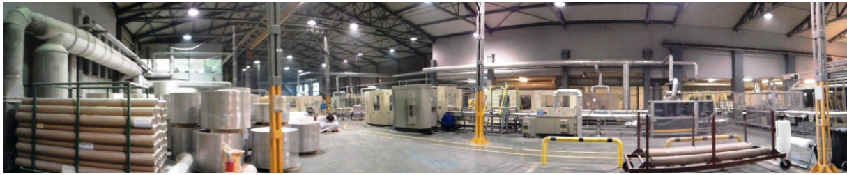
Hala produkcyjna po modernizacji z widocznym systemem kanałów wentylacyjnych
