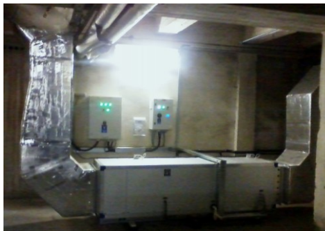
Centrala klimatyzacyjna wraz z układem zasilania i sterowania zainstalowana w piwnicy
